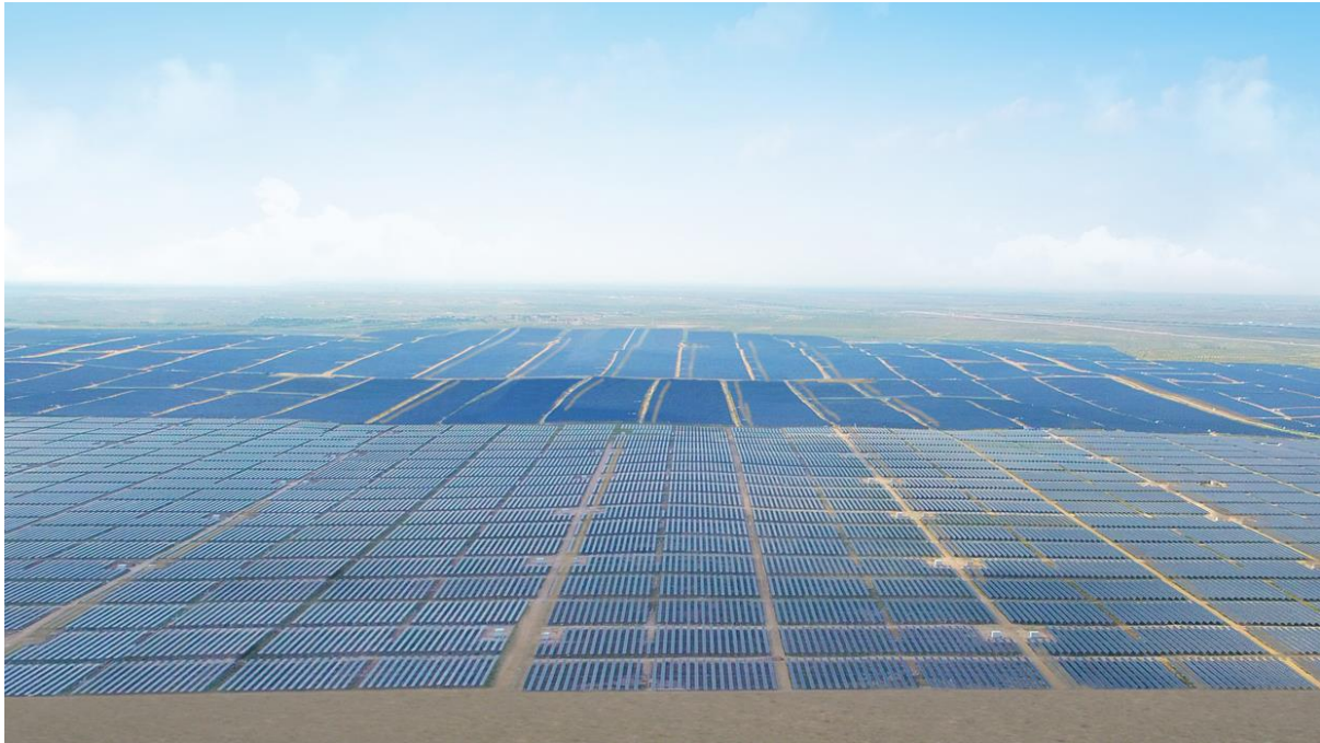
Abbildung 14 Ningxia Kraftwerk, China (Huawei, 2017)
