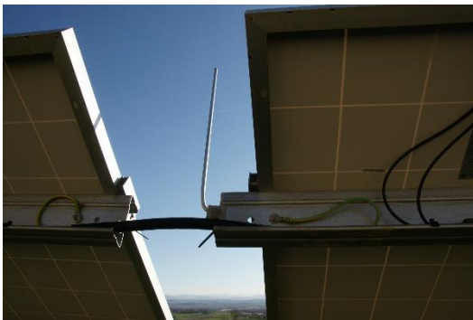
Abbildung 12 Blitzableiter der Solarmodule
