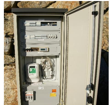
Abbildung 11 Verteilerkasten der Photovoltaikanlage
