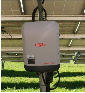
Abbildung 10 Nahaufnahme eines Wechselrichters
