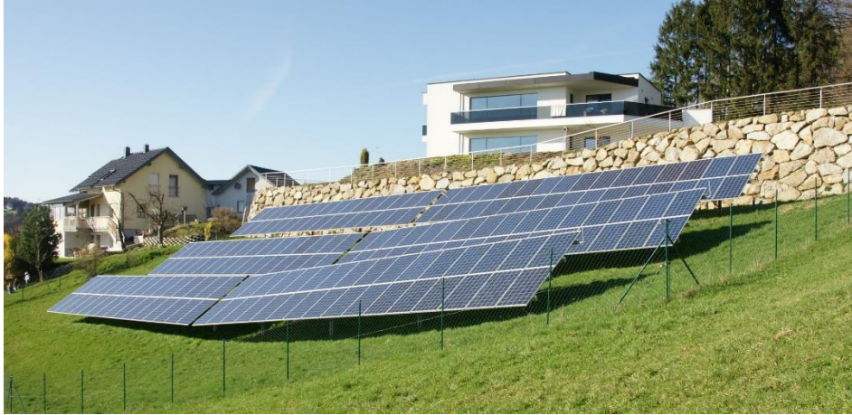
Abbildung 8 Photovoltaikanlage der JMK-Solar KG
